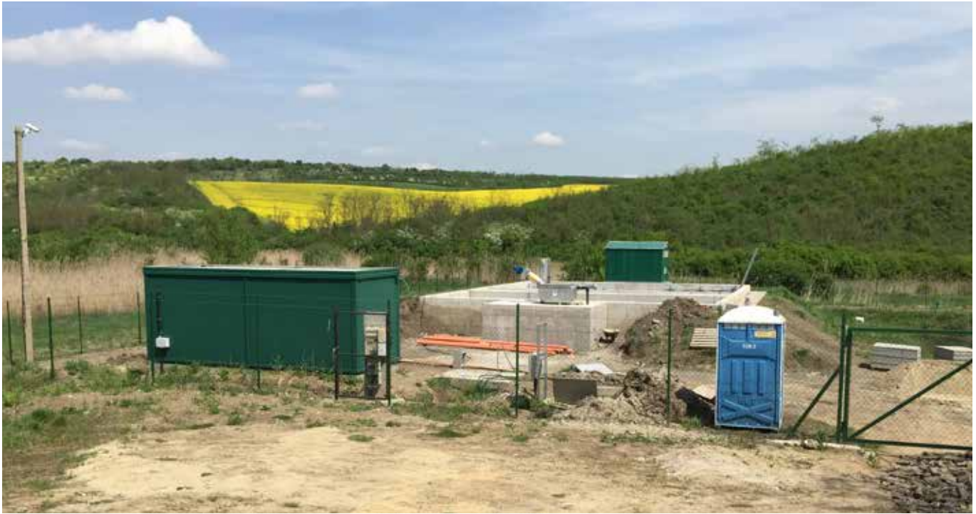
1.225 PE treatment plant, Ungarn
